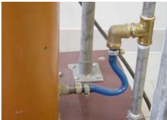
Der Anschluss für das Vakuum am PVC-Rohr
